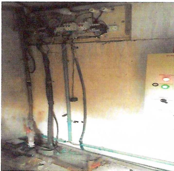
(Foto 12 - Quadro de disjuntores das bombas de alimentação das caixas d'água)
